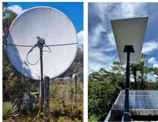
Figura 4. Modernización de la infraestructura de comunicaciones Izquierda. Antena satelital banda C. Derecha. Antena satelital LEO.
